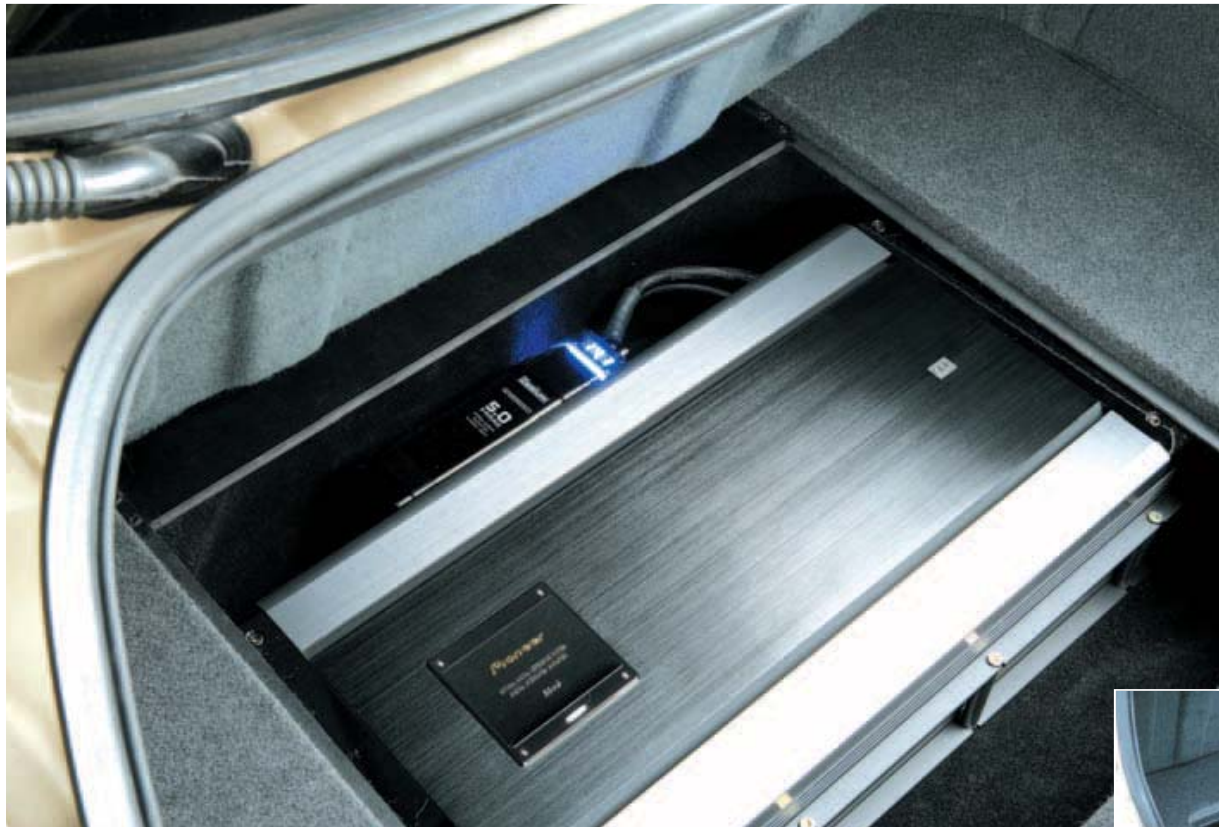
Verstarkt: Im üppig dimensionierten Staufach im Kofferraumboden haben es sich die beiden Verstärker sowie ein Kondensator gemütlich gemacht.
